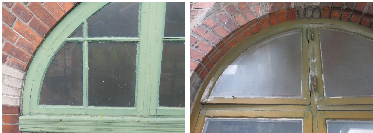
Figur 11 Två typer av träfönster. Till vänster den äldre varianten och till höger den nyare. Notera hur de övre bågarna slagit sig på de nyare fönstren på bilden till höger.
