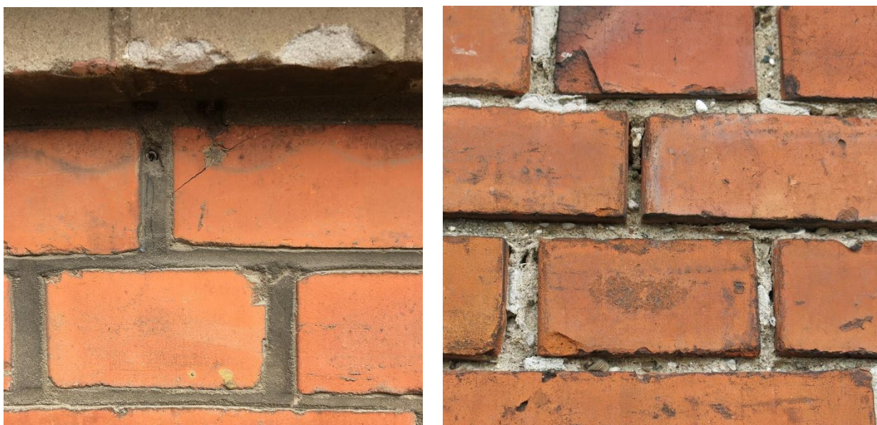
Figur 4 Till vänster en bild på murverket under en solbänk, dvs i skyddat läge. Jämför med bilden till höger som är från den översta delen av den västra fasaden där fogarna har ett betydligt mer utsatt läge och åldrats därefter.
