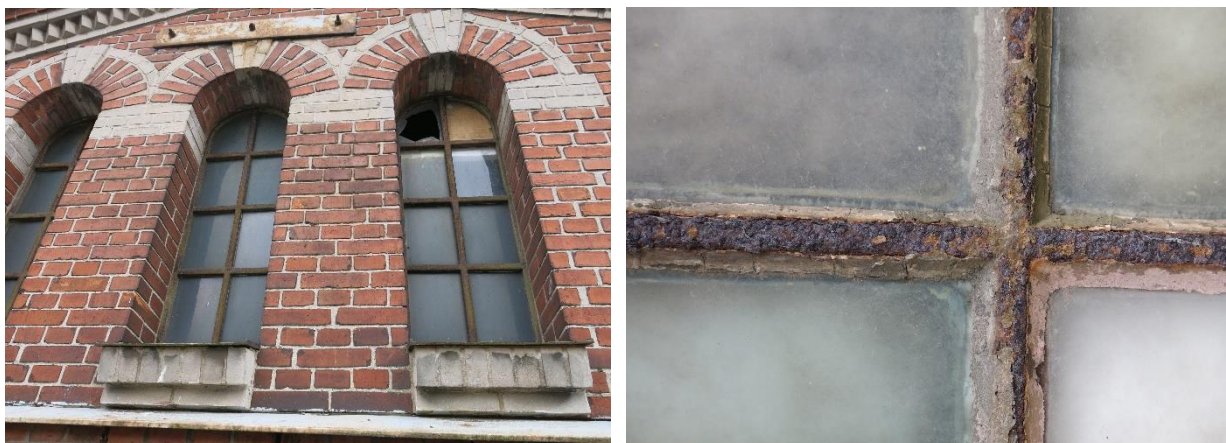
Figur 9 Detaljer från gjutjärnsfönster på byggnadens norra gavel, där fönstren är som mest rostangripna.
